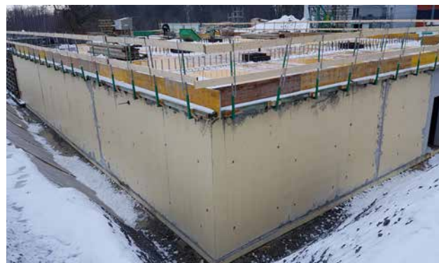
Open bouwkuip met SikaProof® A+: Na het verwijderen van de bekisting moeten de ankerdoorvoeren worden afgedicht.
