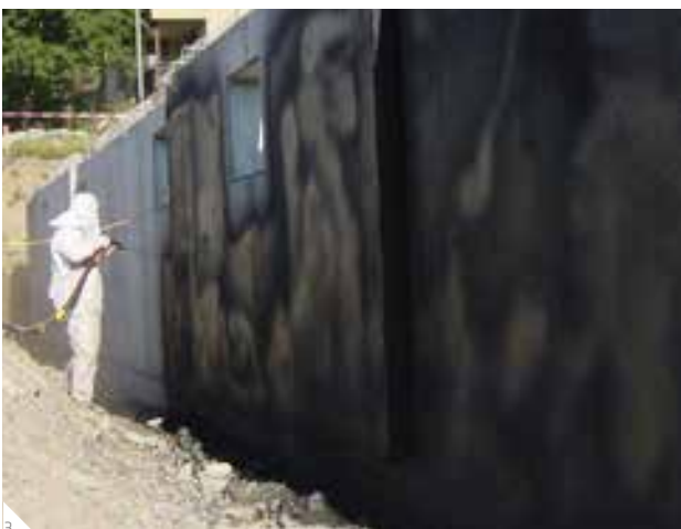
3 Bitumencoatings en -membranen
